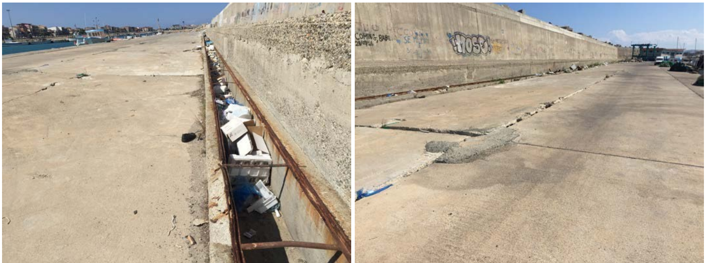
Figura 9.4 Problematiche riscontrate lungo la banchina di levante
