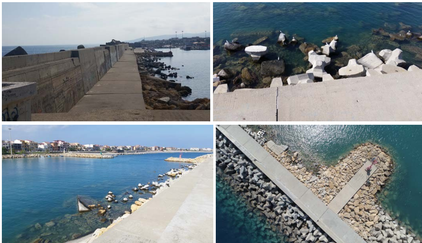
Figura 9.7 Problematiche riscontrate lungo il molo di sopraflutto nell'area dell'avamporto
