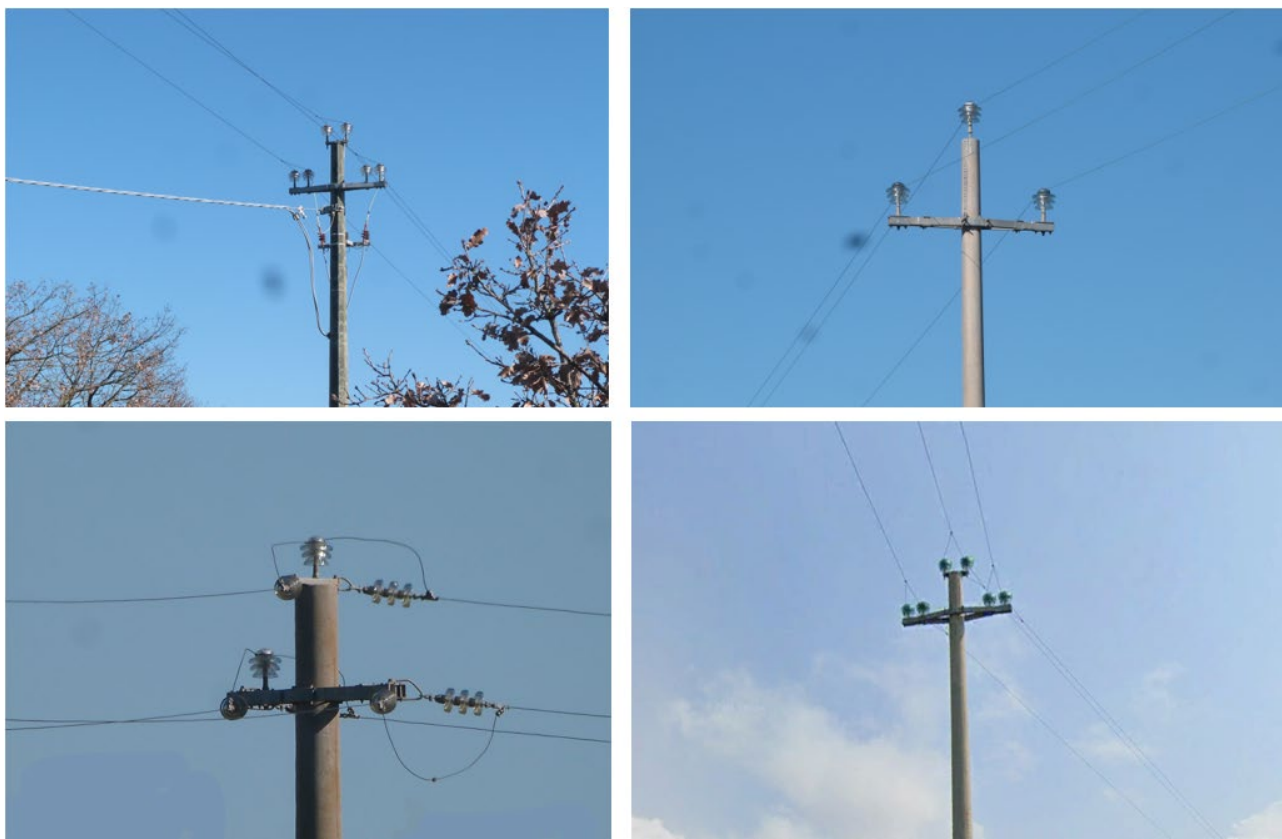
Figura 5. Esempi di tralicci delle linee elettriche MT e BT presenti nell'Area di Progetto e che possono avere un impatto per elettrocuzione sull'avifauna presente.
