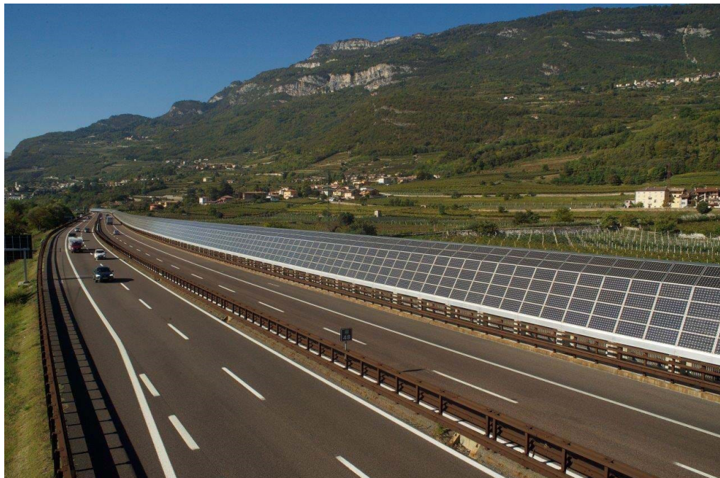
Figura 4: Moduli fotovoltaici installati su una barriera antirumore e fonoassorbente da Autostrada del Brennero
