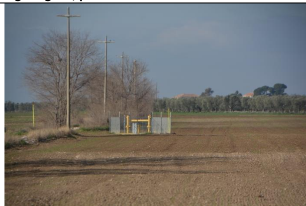
Fig. 4 Fg107, part 25. La cabina del metanodotto
