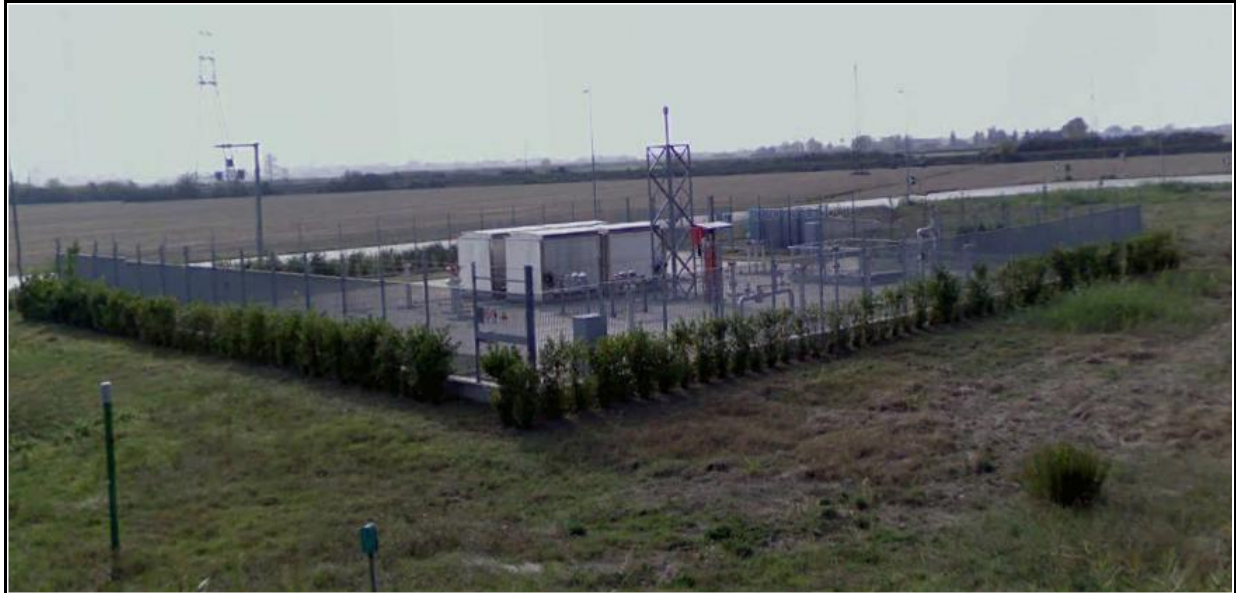
Foto n.11/A – Esempio di Impianto con recente piantumazione di fascia di mascheramento.
