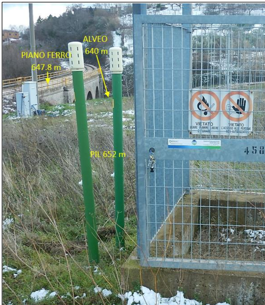
Figura 2.2/B – Immagine dell'impianto esistente da sostituire. Indicato il vallone e le quote salienti
