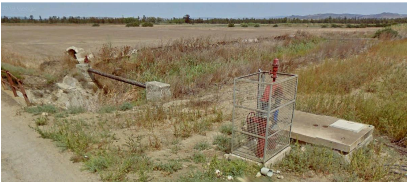
Figura 3: artificializzazione del Rio e organi di manovra
