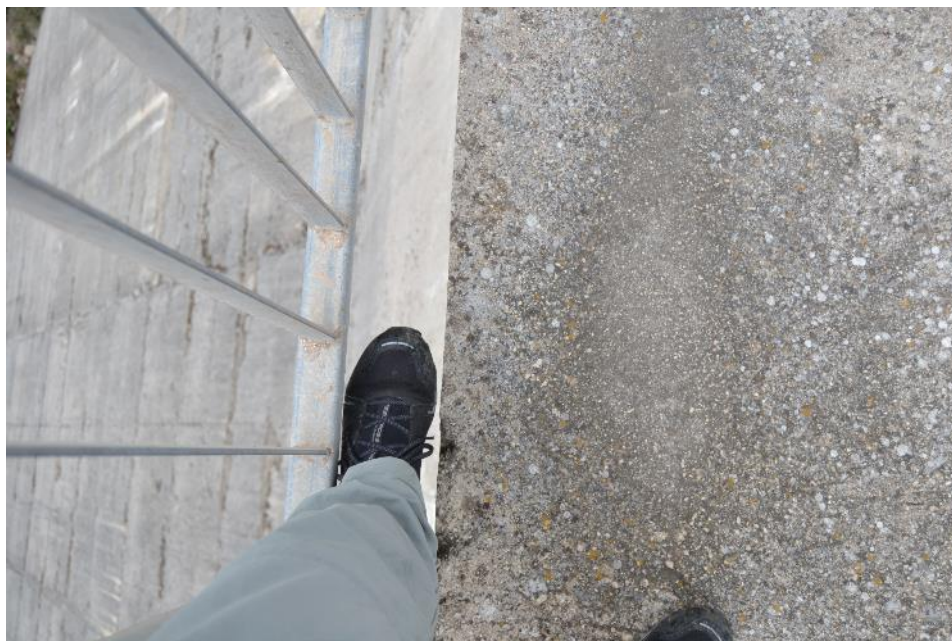
Figura 20 - Criticità del parapetto
