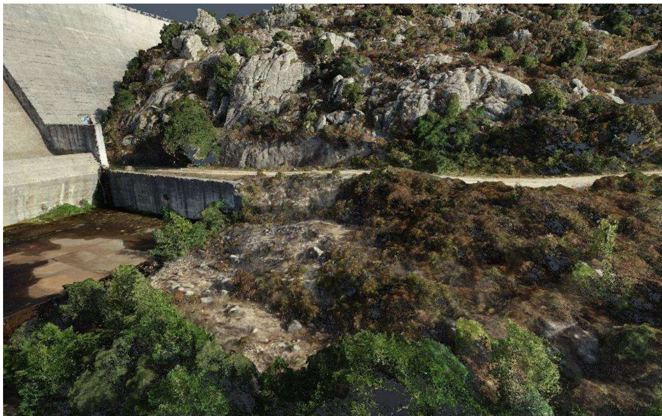
Figura 5-3 estratto nuvola di punti - erosione della sponda in sinistra idraulica
