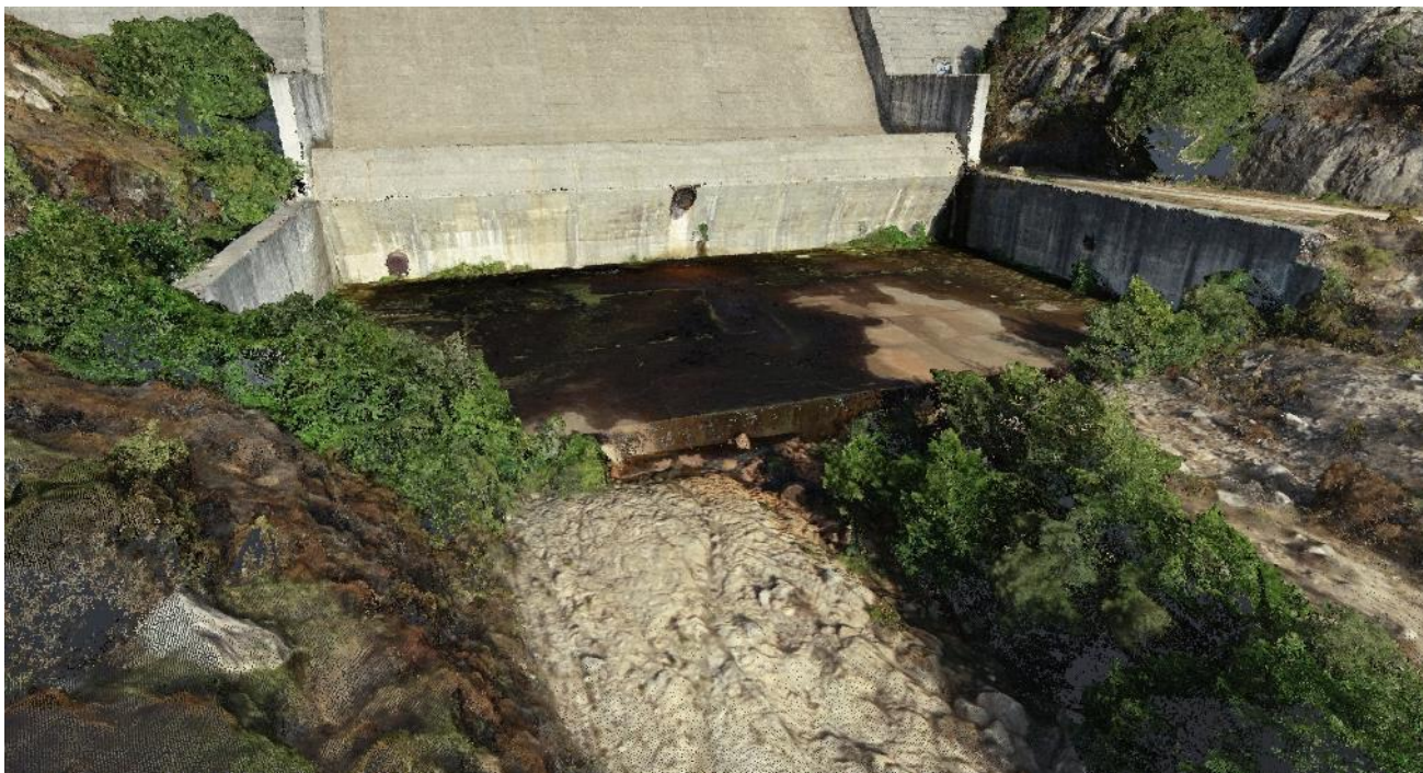
Figura 7 estratto nuvola di punti - erosione alla base della platea
