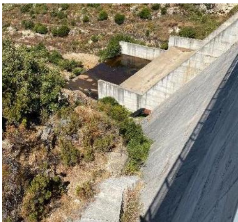
Figura 19 scala di accesso ai cunicoli lato Sud non terminata
