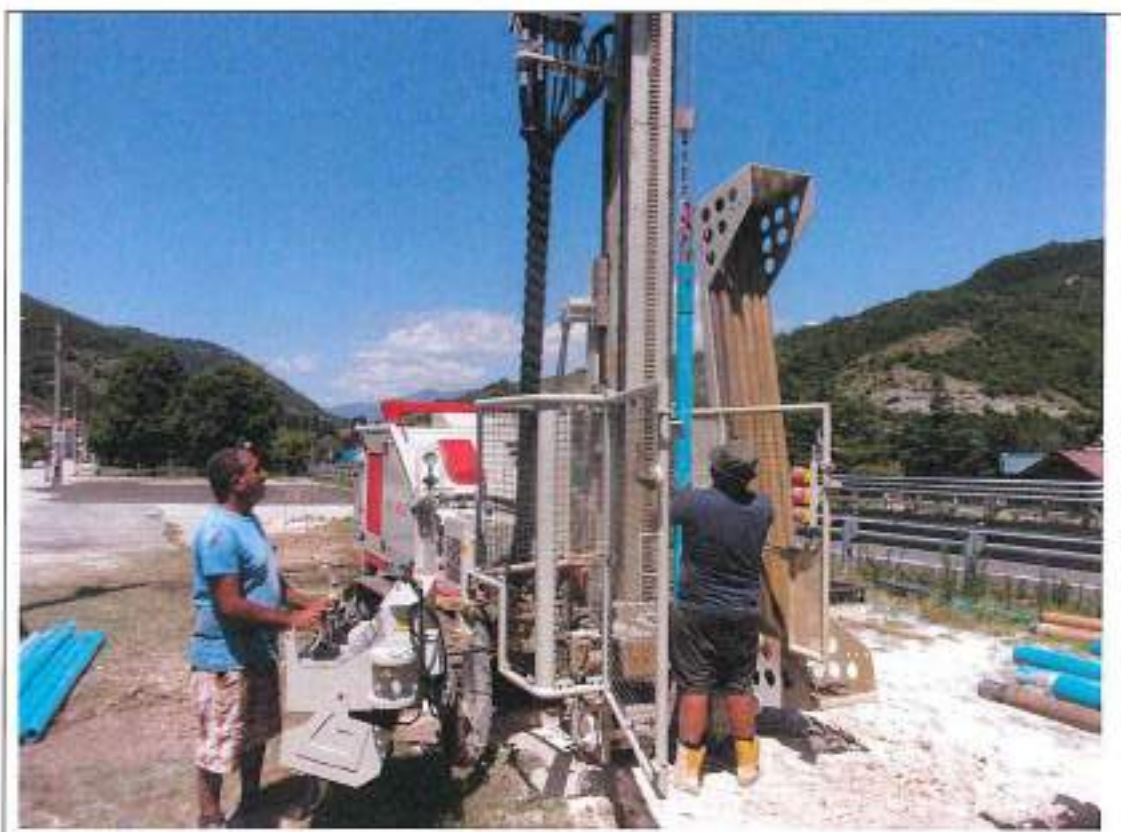
Tubi piezometrici in corrispondenza del sondaggio S9(pz)
