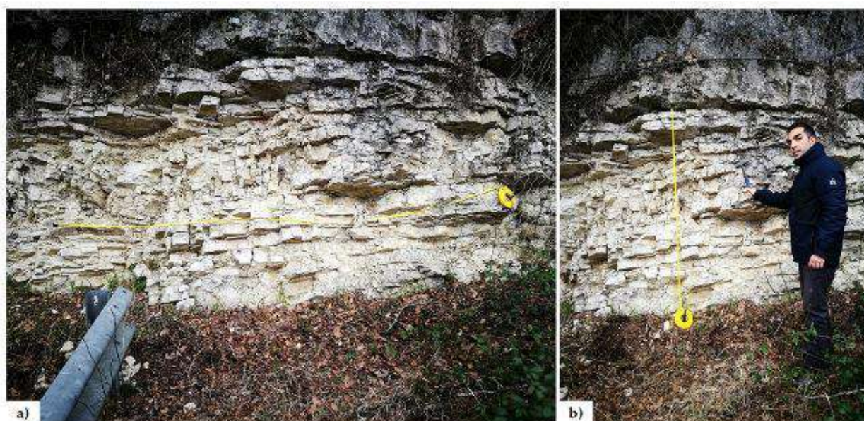
Figura 218 - Esempio di scan line per il rilievo geomeccanico oggettivo, sia orizzontale al piano campagna (a) sia verticale allo stesso (b). In particolare, nell'immagine è mostrato il rilievo della stazione k04 in Scaglia Detritica (SCZ) presso la Valle del Turano.
