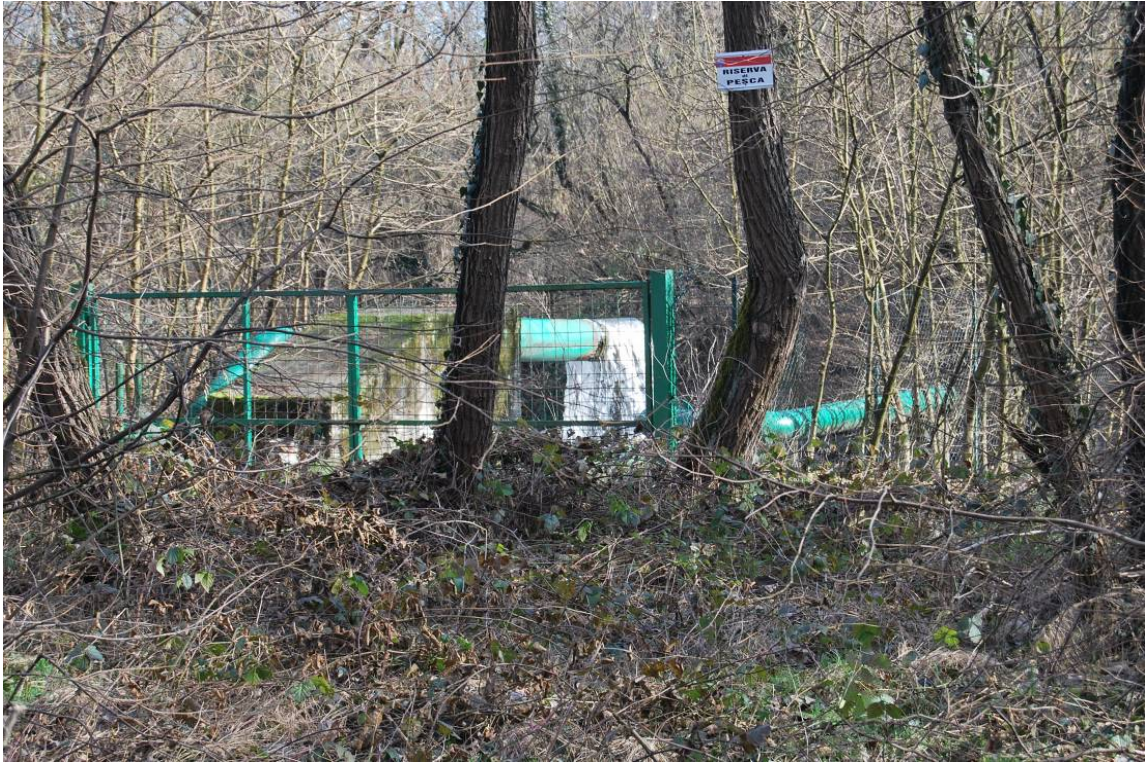
Fig. 53 – Vista della parte laterale dell'impianto di scarico
