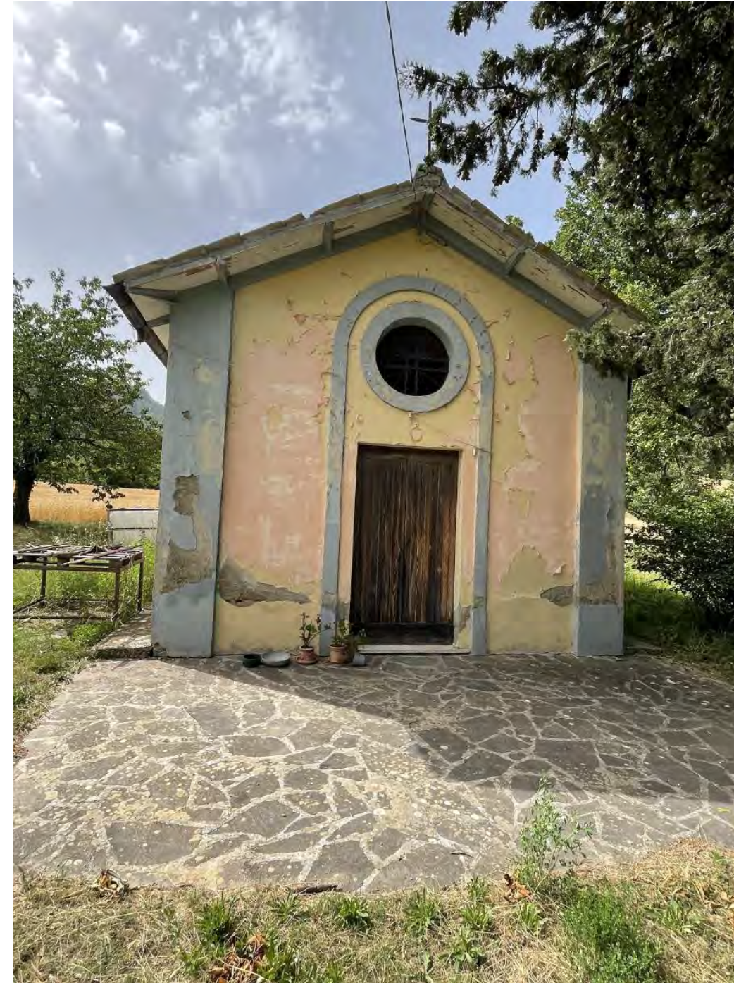
Foto 7-2 Chiesa rupestre in stato di abbandono.
