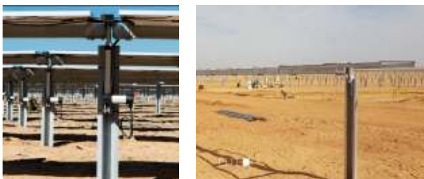
Figura 4 - Particolare strutture ad inseguimento ed attuatore
