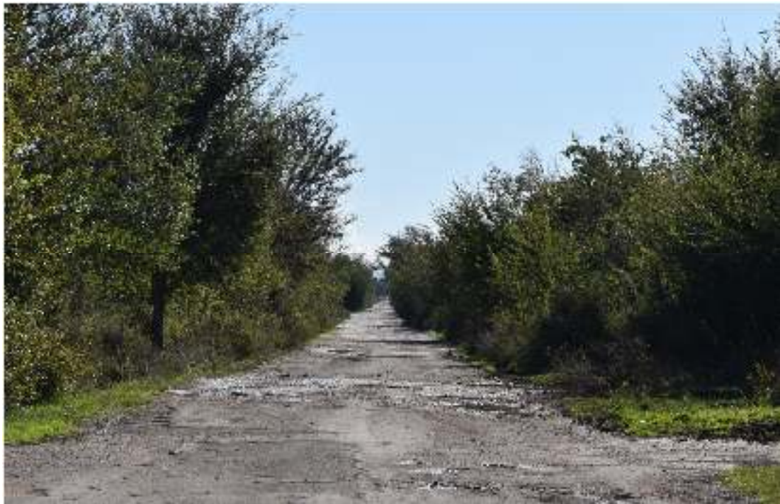
Figura 17 – Tratto della Strada Provinciale 13
