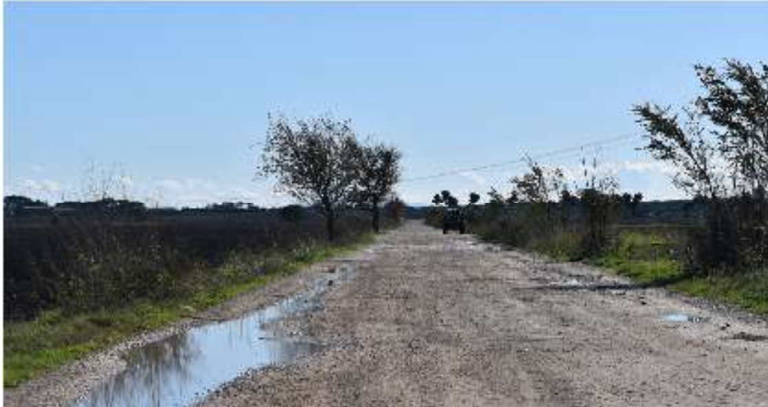
Figura 16 – Tratto della Strada Provinciale 13
