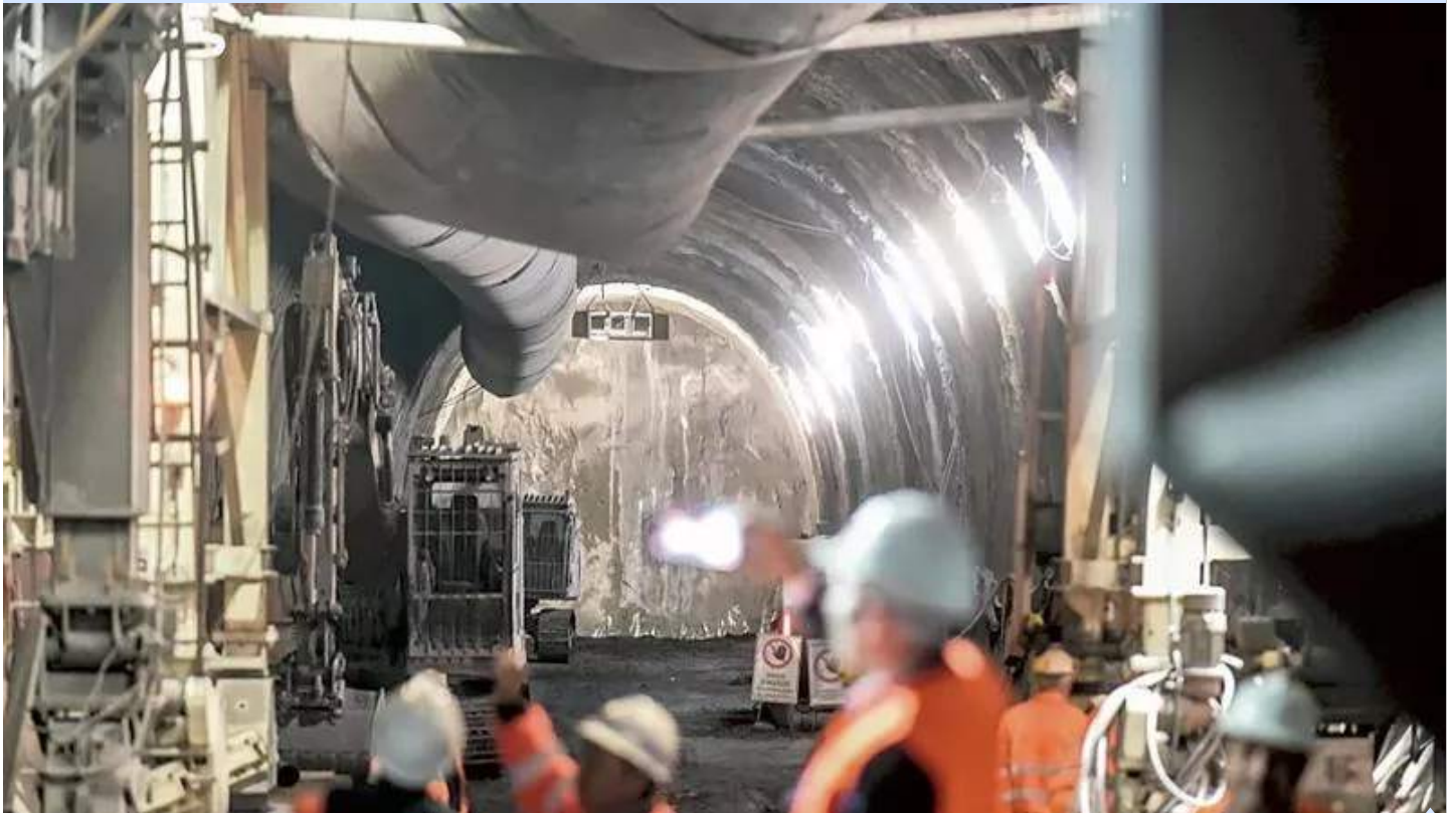
I lavori nel cantiere del Terzo Valico ferroviario in un'immagine d'archivio (foto Balostro)
