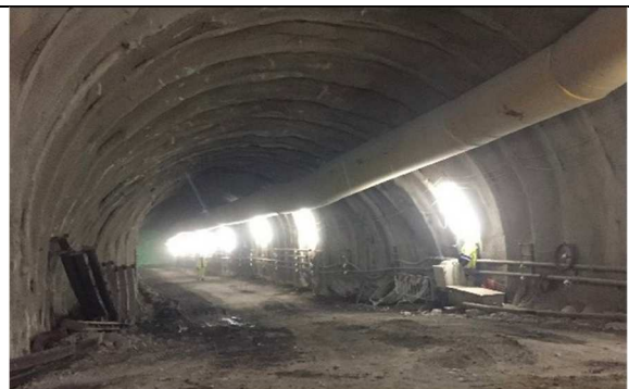
Bypass di collegamento tra la Galleria Nuova San Tomaso e la Galleria Nuova Colombo(*)
