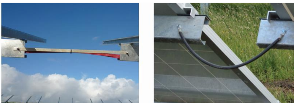
Figura 6: Collegamento equipotenziale tra strutture adiacenti
