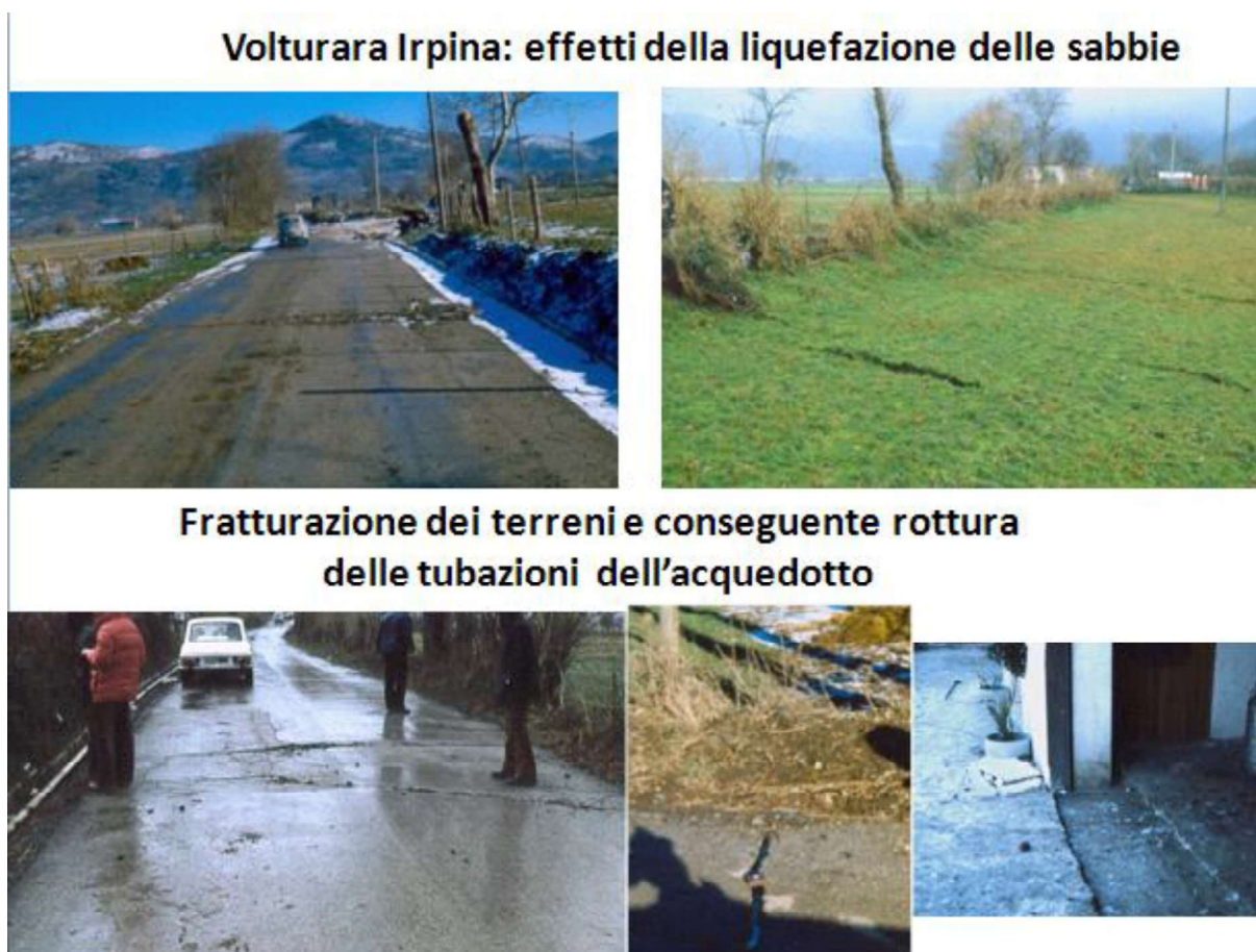
Fig. 31 - Fagliazione fino in superficie dei sedimenti sciolti (con fenomeni di liquefazione) nella Piana del Dragone nel Comune di Volturara Irpina. Le fratture hanno tranciato il tubo dell'acquedotto.
