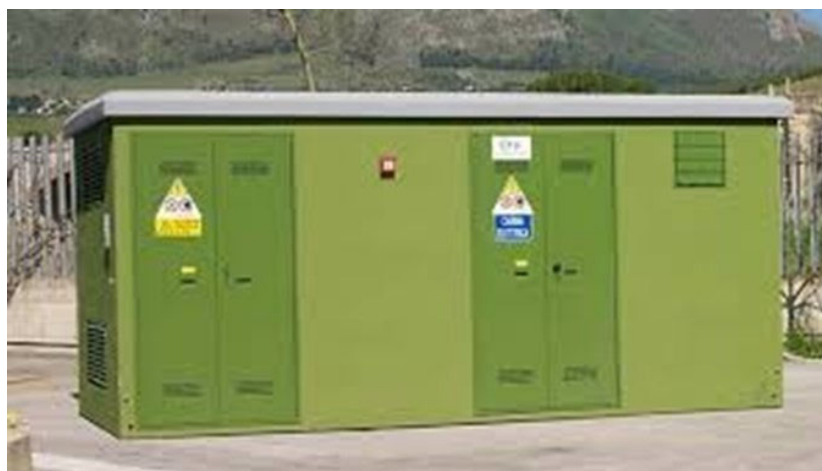
Figura 16: Cabina prefabbricata tipica utilizzata in progetto
