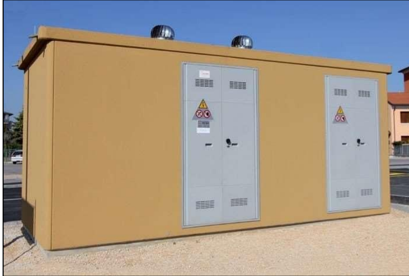
Figura 23: Tipica cabina elettrica
