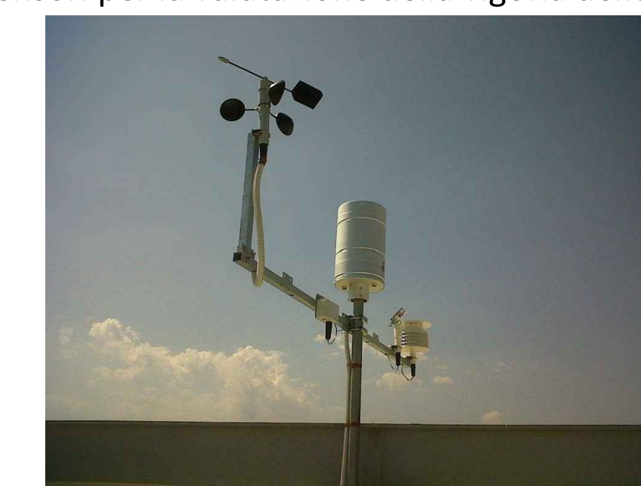
Centraline di controllo parametri microclimatici per lo studio del clima in esercizio dell'impianto
