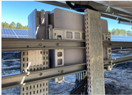
Figura 7: Supporto per quadri elettrici
