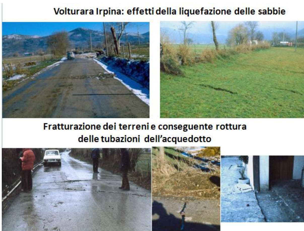
Fig. 31 - Fagliazione fino in superficie dei sedimenti sciolti (con fenomeni di liquefazione) nella Piana del Dragone nel Comune di Vulturara Irpina. Le fratture hanno tranciato il tubo dell'acquedotto.
