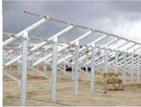
FIGURA 2 - STRUTTURE DI SOSTEGNO (TRACKER)
