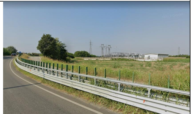
FIGURA 13 - VISTA 10 SP 185 - CABINA DI CONSEGNA
