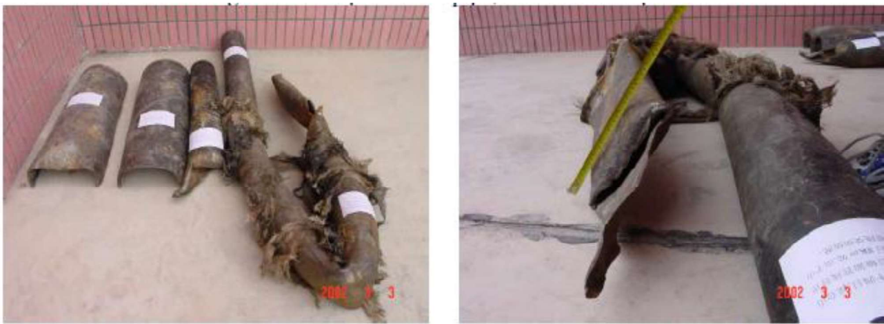
Fig. 26 - Danni subiti dalla condotta durante il terremoto del 2001 vicino a Qinghai-Xinjiang, Cina.
