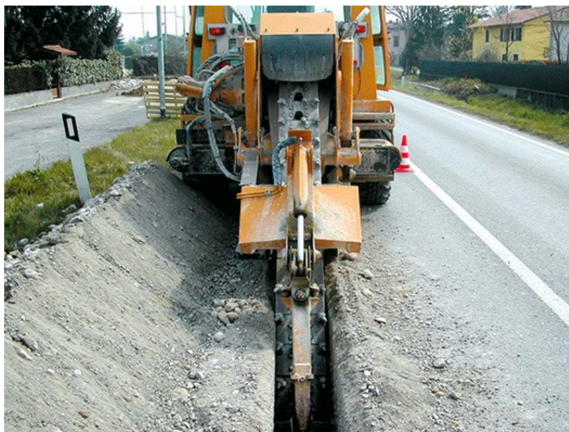
Figura 5-1. Esempio di mezzo di piccole dimensioni per la realizzazione dello scavo per la posa del cavidotto.
