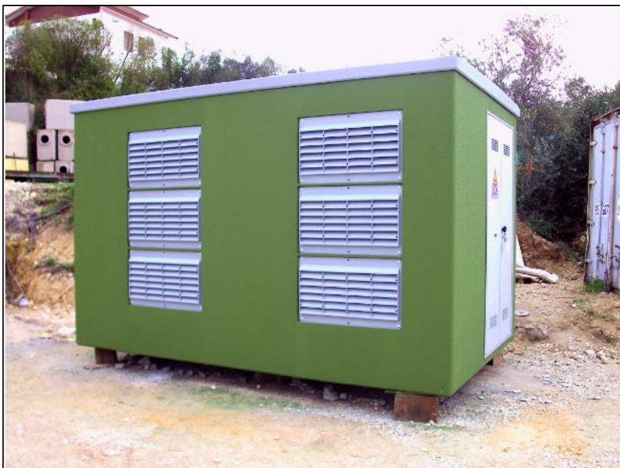
Tipico cabina elettrica prefabbricata
