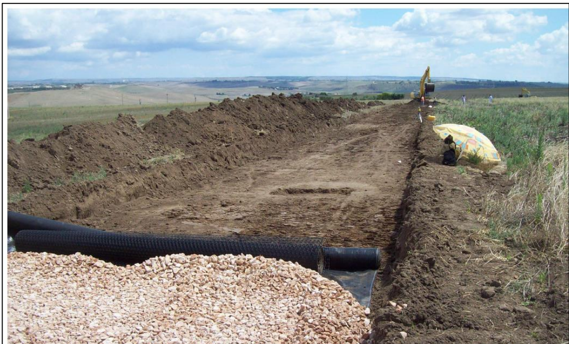
Viabilità brecciata di nuova realizzazione – Fase di scavo superficiale (scotico) si nota il terreno vegetale posizionato a bordo scavo
