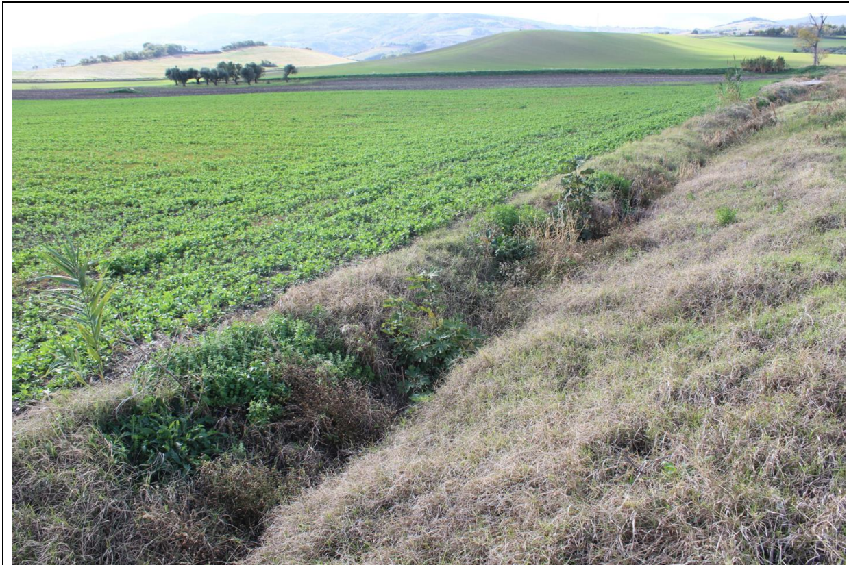
Fig. Tronco 1 nel punto di inserimento di un'opera idraulica al di sotto della strada temporanea di accesso della WTG 2 (Sopralluogo 17.11.2022)
