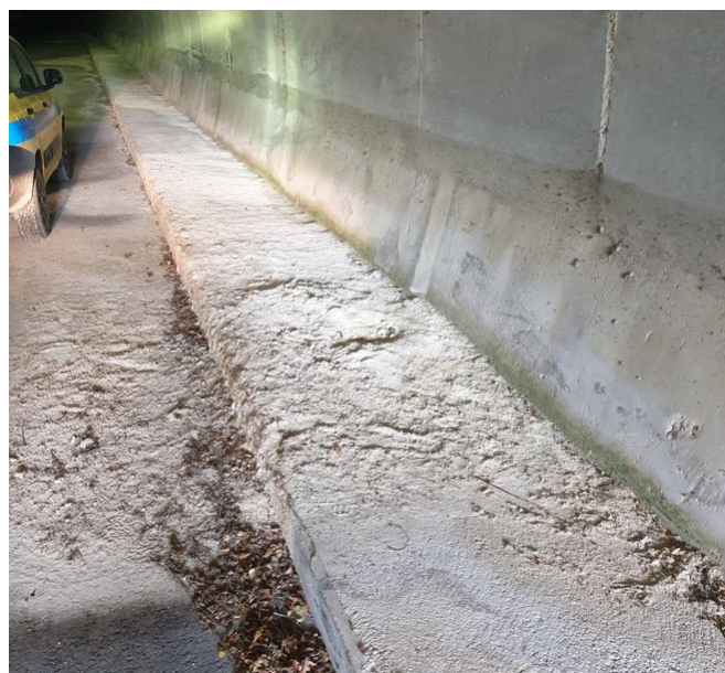
Figura 15: Galleria S. Antonio Sud - Incrostazione mineralizzata [foto da sopralluogo del 05/10/2021]
