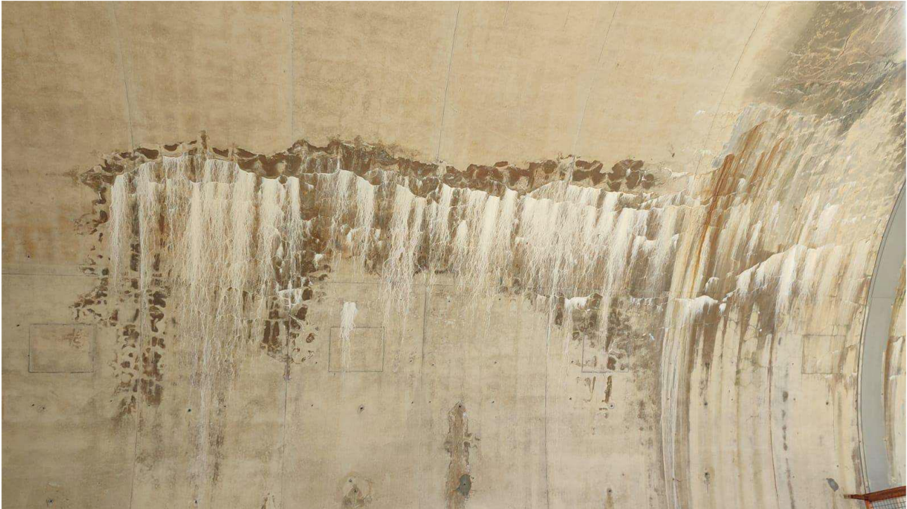
Figura 4: Esempio di concrezioni d'acqua diffuse – Galleria S. Veronica – dalla p.k. 0+010 alla p.k. 0+015 circa
