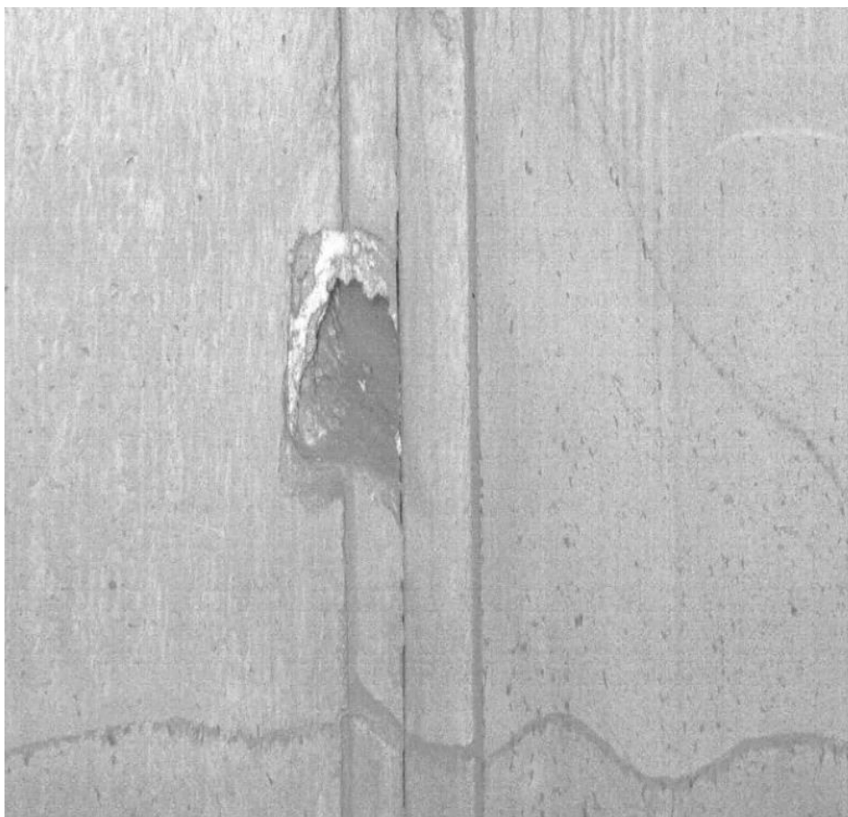
Figura 19: Esempio di danno scheggiatura - Galleria Guinza p.k. 0+667 circa
