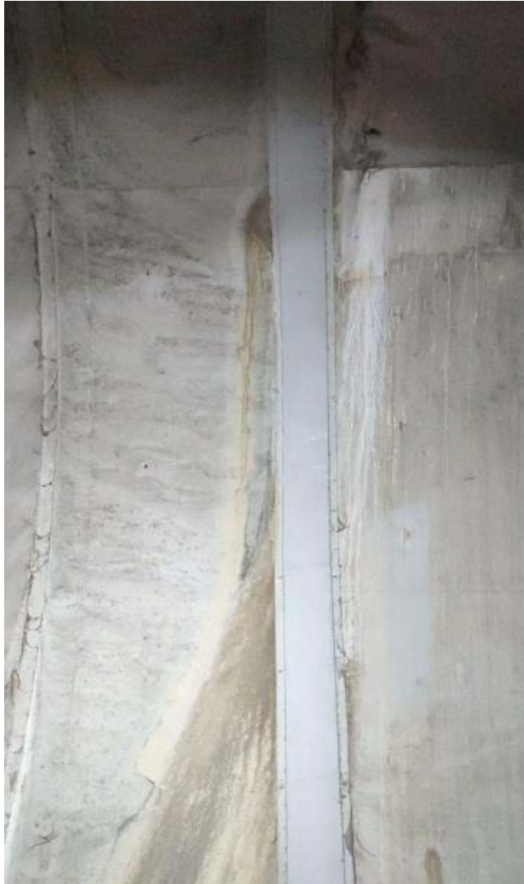
Figura 16: Esempio giunto coperto da lamiera - Galleria S. Antonio Nord p.k. 0+784
