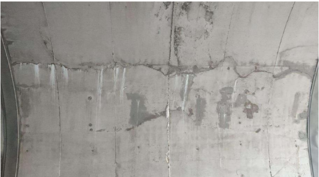
Figura 3: Esempio fessura con concrezioni - Galleria S. Antonio Nord - dalla p.k. 0+025 circa
