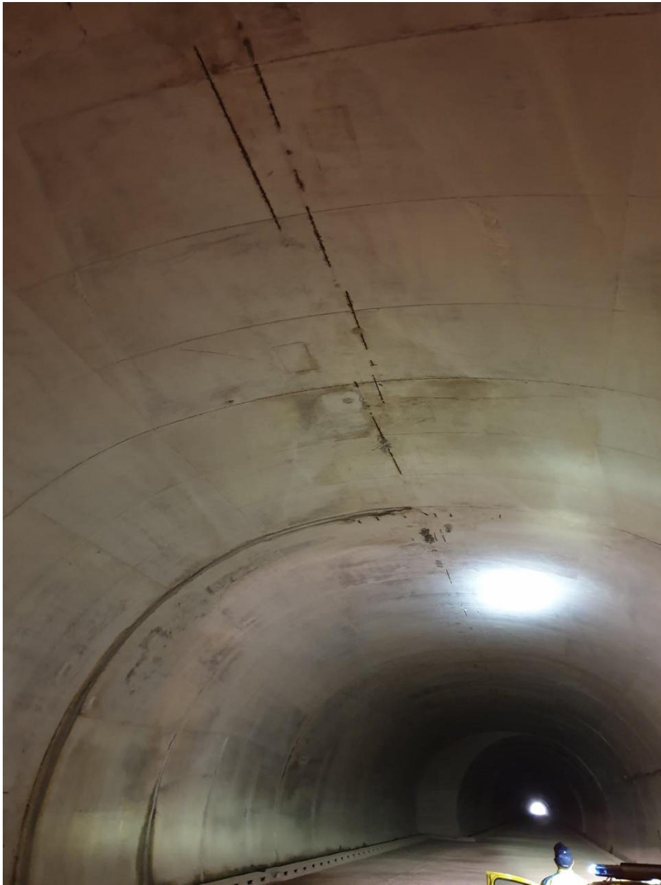
Figura 10: Armatura esposta in calotta Piazzola n.01 - Galleria Guinza
