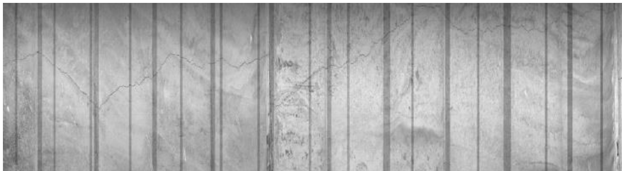
Figura 6: Esempio di fessure asciutte - Galleria Valpiana - dalla p.k. 0+150
