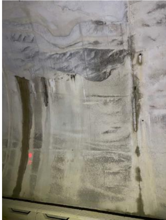
Figura 2: Esempio di fessura con concrezioni – Galleria Guinza dalla p.k. 5+403 alla p.k.5+408 circa
