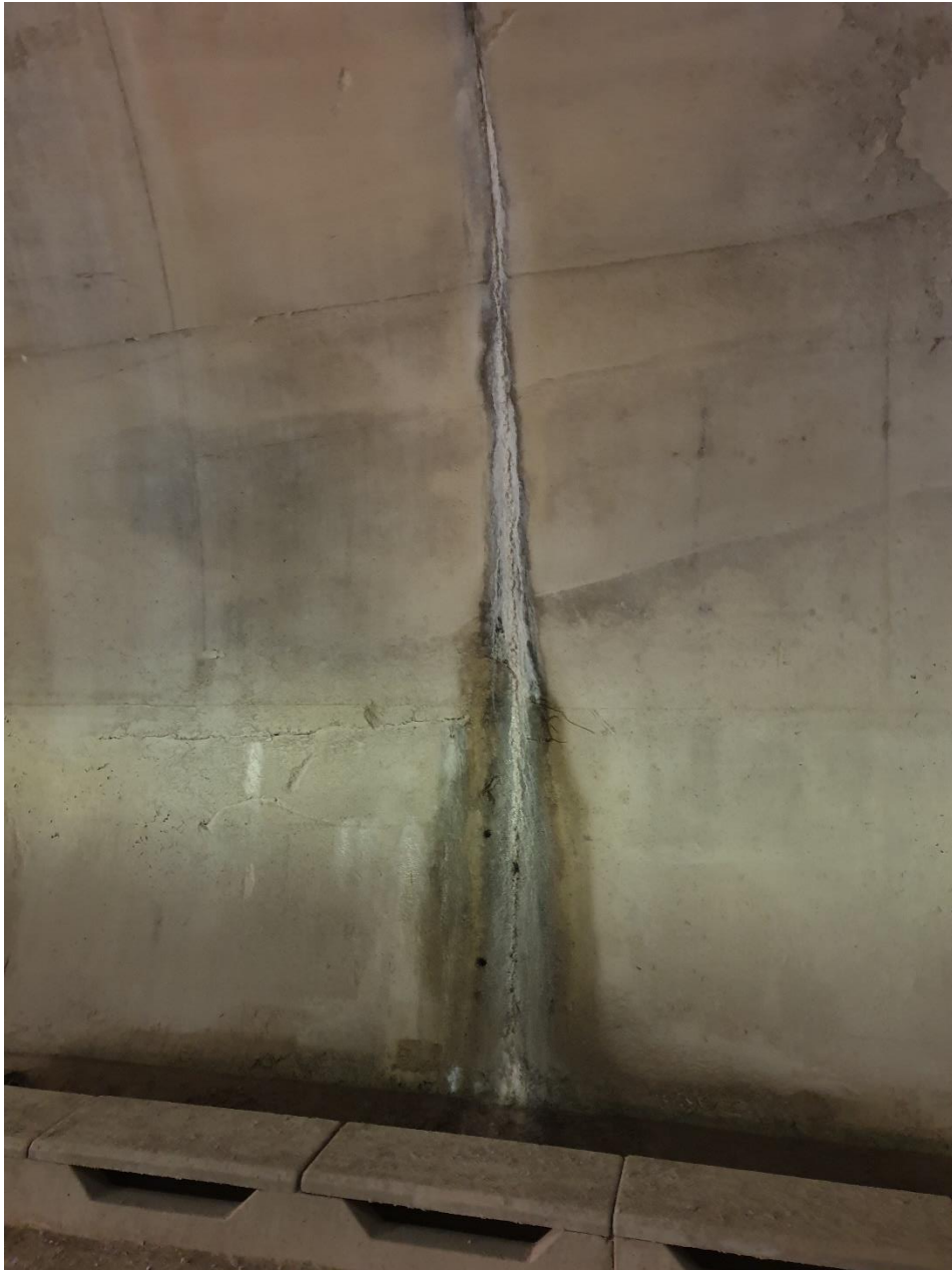
Figura 13: Esempio venuta d'acqua in corrispondenza della ripresa di getto - Galleria Guinza [foto da sopralluogo del 05/10/2021]
