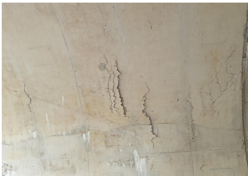
Figura 18: Esempio esfoliazione sulla calotta della Galleria S.Veronica [foto da sopralluogo del 05/10/2021]
