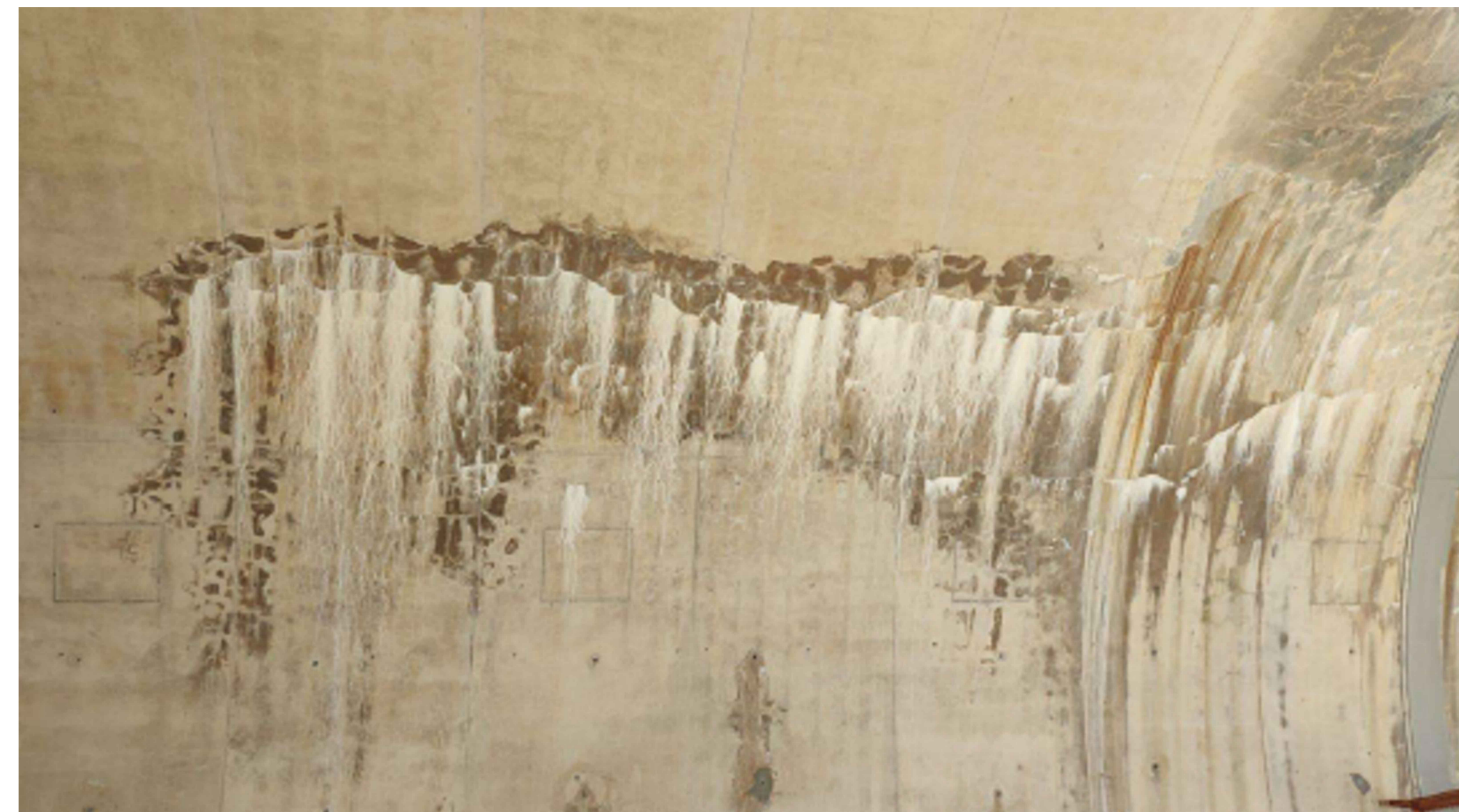
Esempio di concrezioni d'acqua diffuse - Galleria S. Veronica - dalla p.k.0+010 alla p.k. 0+015 circa
