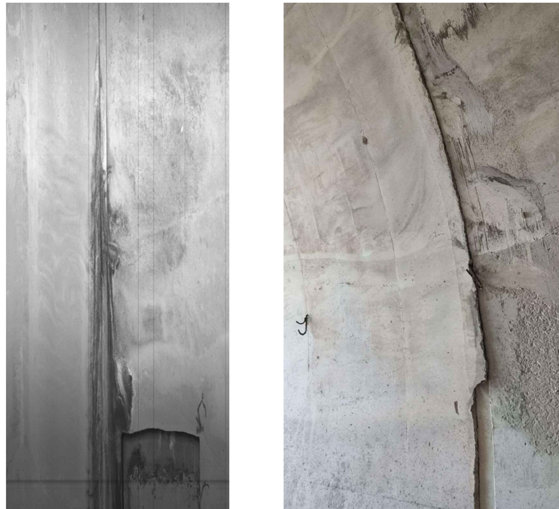
Esempio di giunto ammalorato - Galleria Guinza - p.k. 5+932 circa
