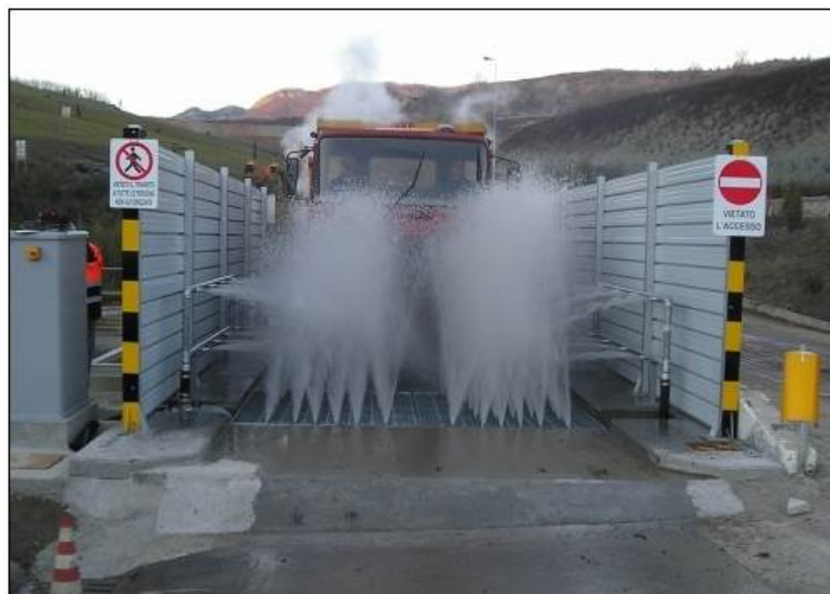
Figura 10 - Impianto lavaggio ruote
