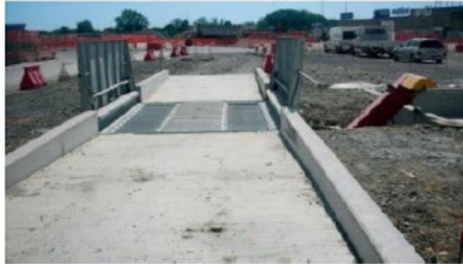
Figura 80 - Impianto di lavaggio pneumatici
