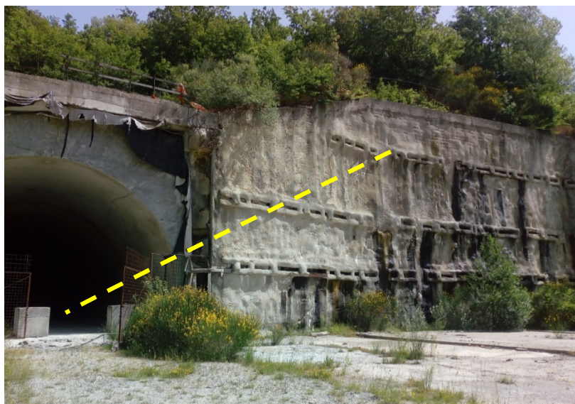
Stillicidio attraverso la paratia di imbocco della Galleria Guinza lato Umbria
