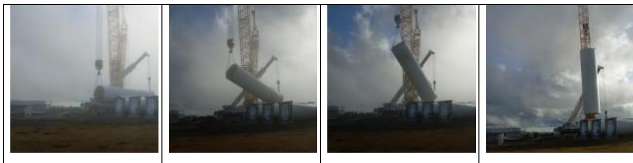
Figura 5.35 – Schema delle fasi di sollevamento dei componenti dell'aerogeneratore (Fonte sito web http://www.windfarmbop.com/ )
