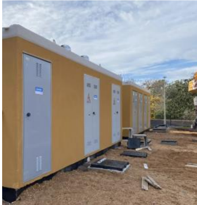
Figura 9: esempio di cabina in C.A.V.. La parte nera costituisce la vasca di fondazione e raccolta cavi, che sarà interrata.
