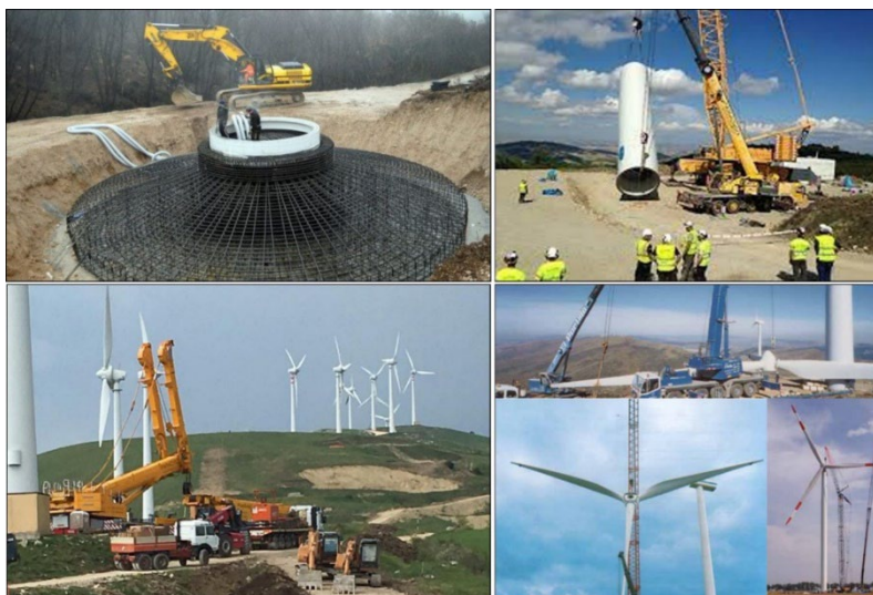
Fig. 9 - Alcune fasi di cantiere per la realizzazione di un Impianto eolico (Fonte: web)
