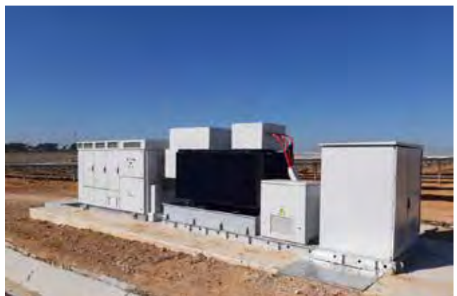
SPAIN Los Limonetes, 46 MW HEMK + MV SKID
