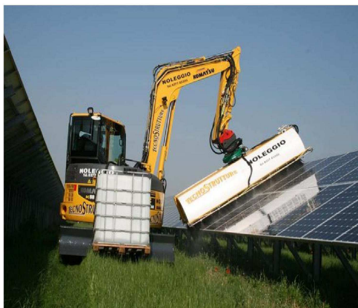
Fig. 26. Sistema automatizzato lavaggio moduli fotovoltaici
