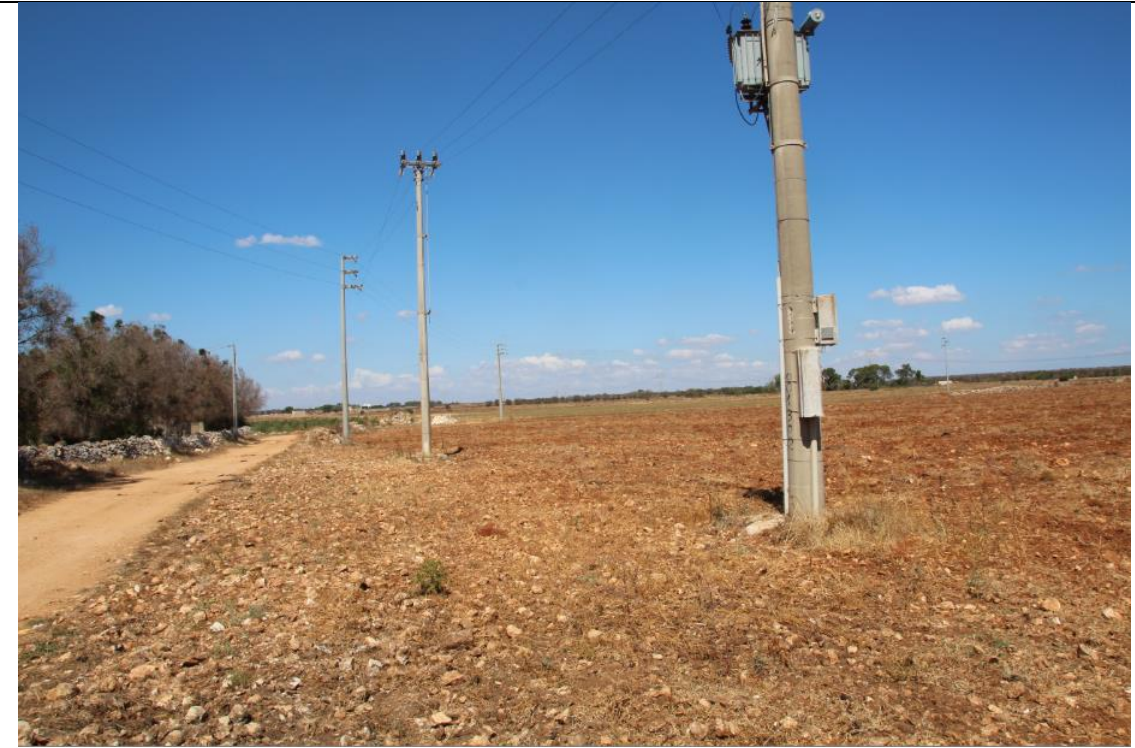
Punto scatto n.36: Linee elettriche aeree MT
