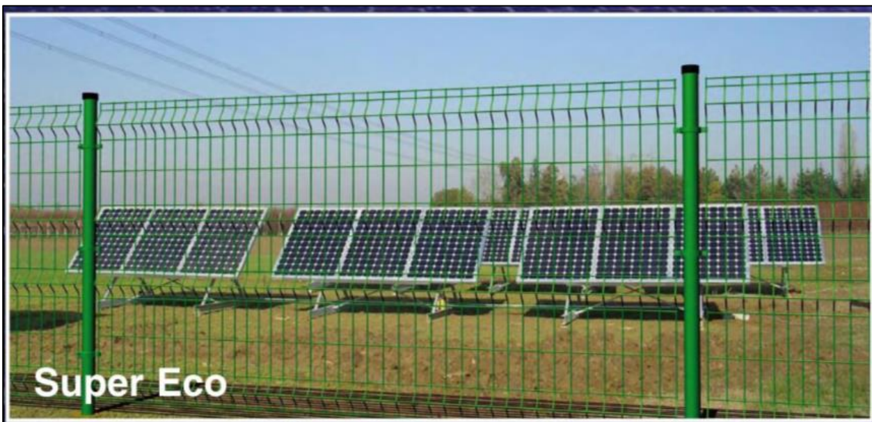
Fig.: Tipico della recinzione perimetrale di impianto
