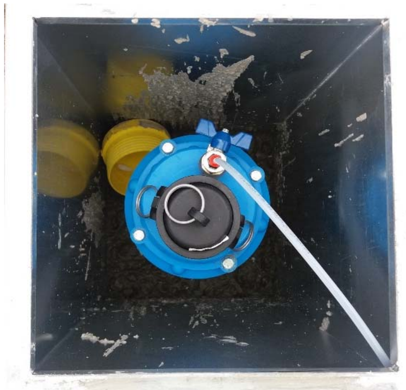
Fig. 1 - Testa pozzo a tenuta predisposta sui piezometri risultati “secchi”.
