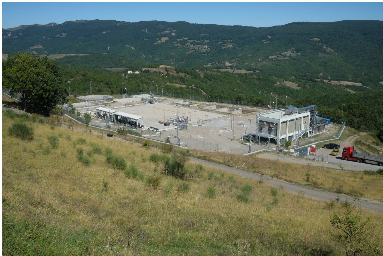
Figura 16: Immagine del pozzo Tempa 1 in esercizio. Fonte: WSP Golder, 2022.
