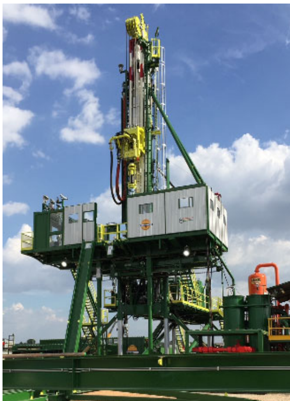
Figura 15: Impianto PERGEMINE WEI DS 230 utilizzato per attività di manutenzione in fase di esercizio. Fonte: TotalEnergies.
