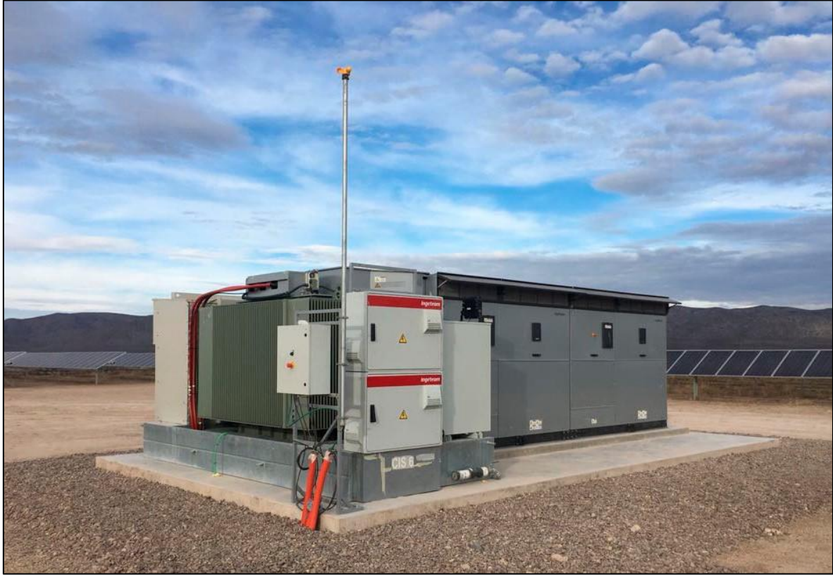
Fig. 5: Cabine di trasformazione
