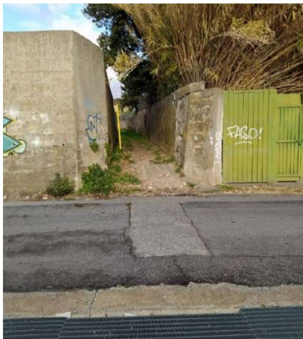
Punto di immissione delle acque di esondazione dall'impluvio urbano in uscita dal secondo sottopasso autostradale A10. In primo piano la griglia carrabile del canale in fregio alla ferrovia
