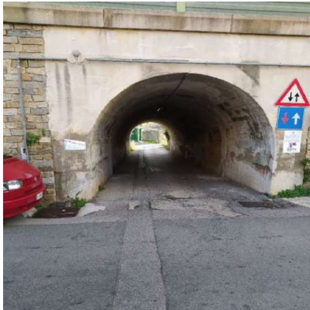
Secondo sottopasso autostrada A10 – imbocco lato monte nel punto di concentrazione dell'impluvio urbano
