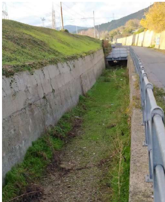
Tratto del canale in fregio alla ferrovia con griglie e ponticelli, in grado di ricevere le acque di esondazione del Fontanazza che defluiscono sulla strada, provenienti da due sottopassi autostradali.
