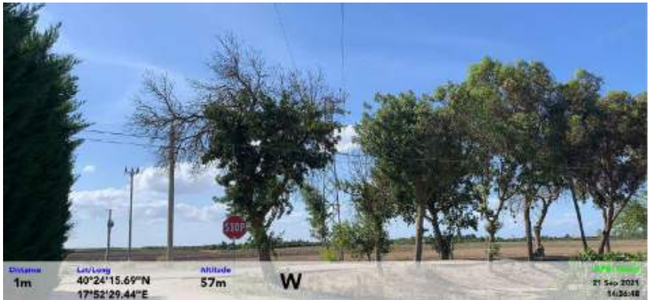
Figura 128 - Interferenza con linea di bassa e media tensione e con linea telefonica
