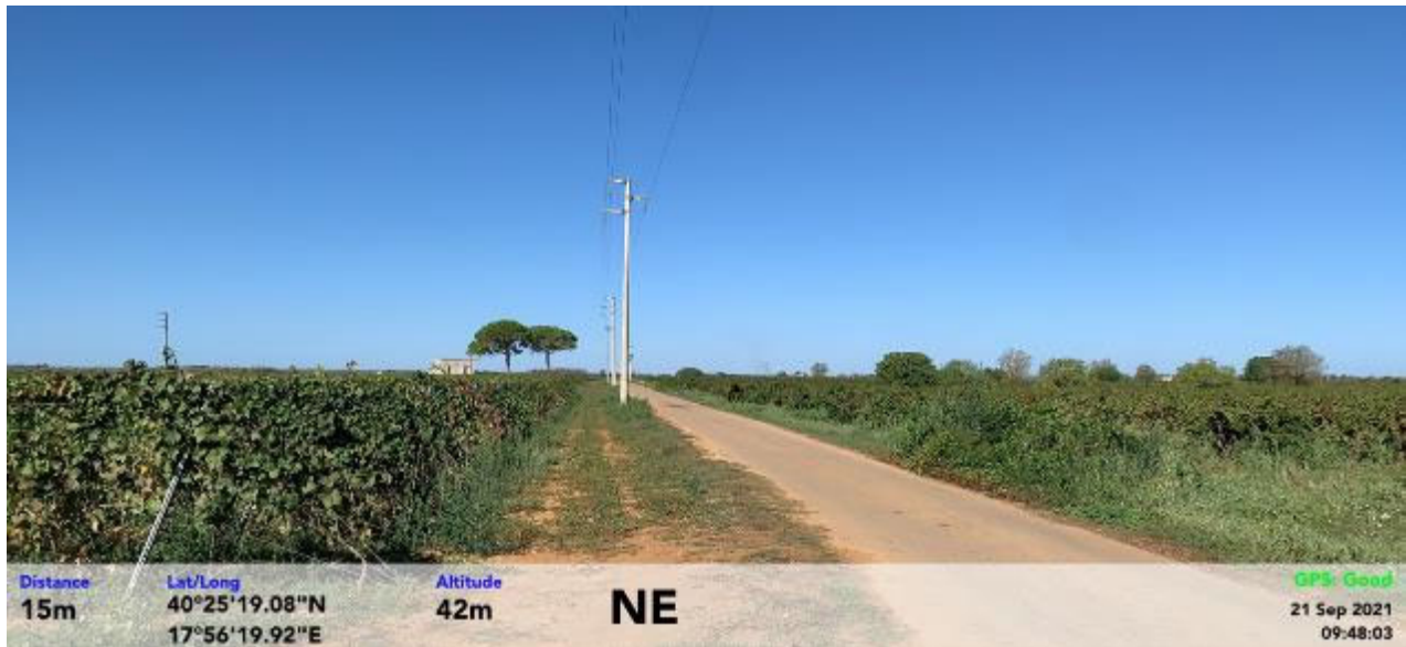
Figura 17 - Linea di media tensione lungo la strada San Donaci-Campi. Area per viabilità di nuova realizzazione sulla destra
