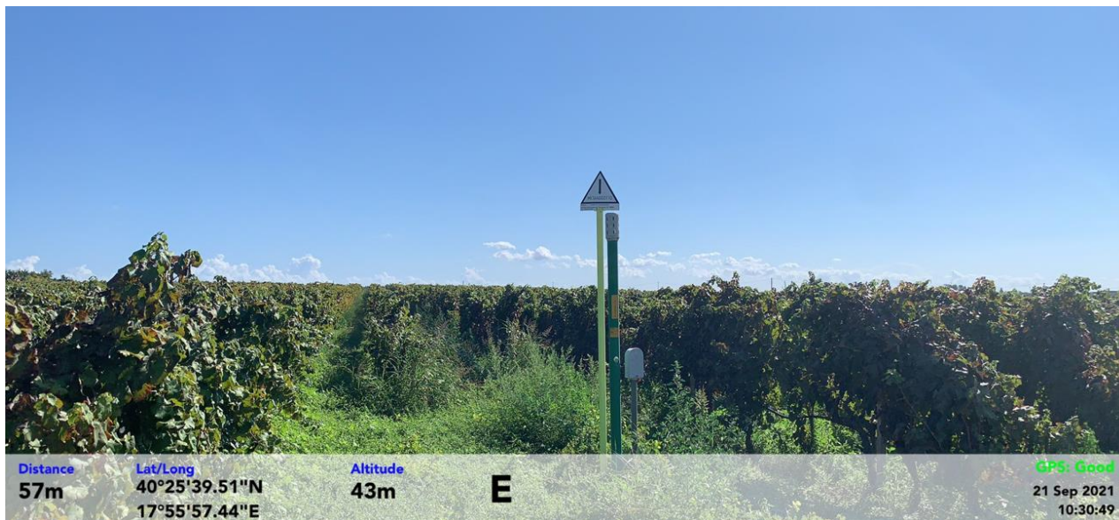
Figura 57 - Paletto di segnalazione del metanodotto
