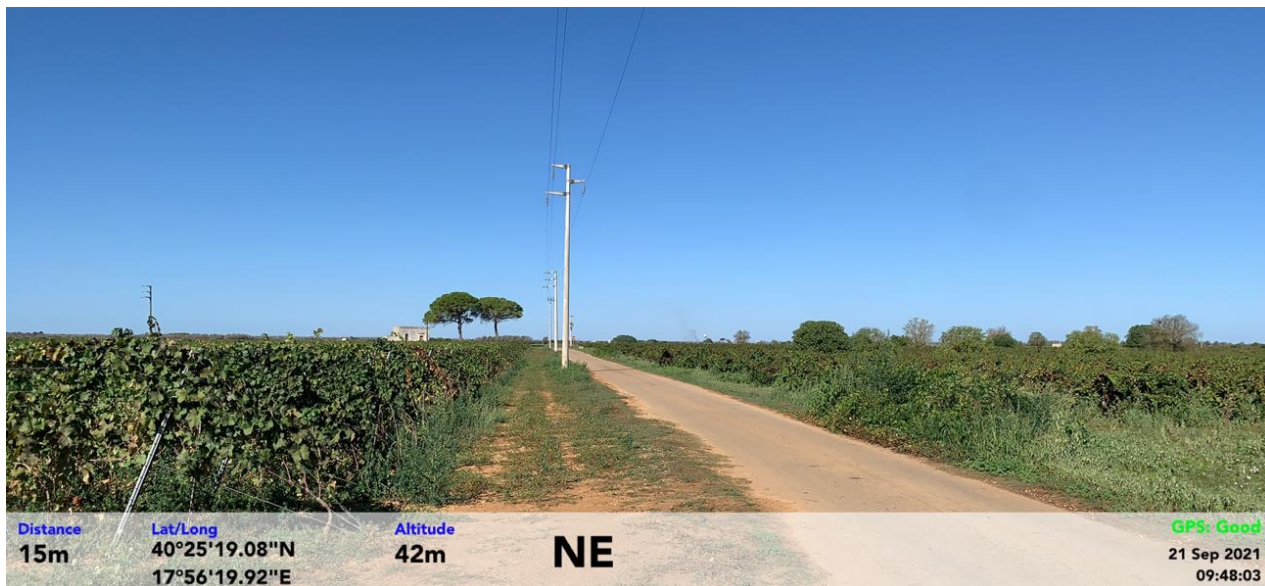
Figura 49 - Linea di media tensione lungo la strada San Donaci-Campi. Area per viabilità di nuova realizzazione sulla destra
